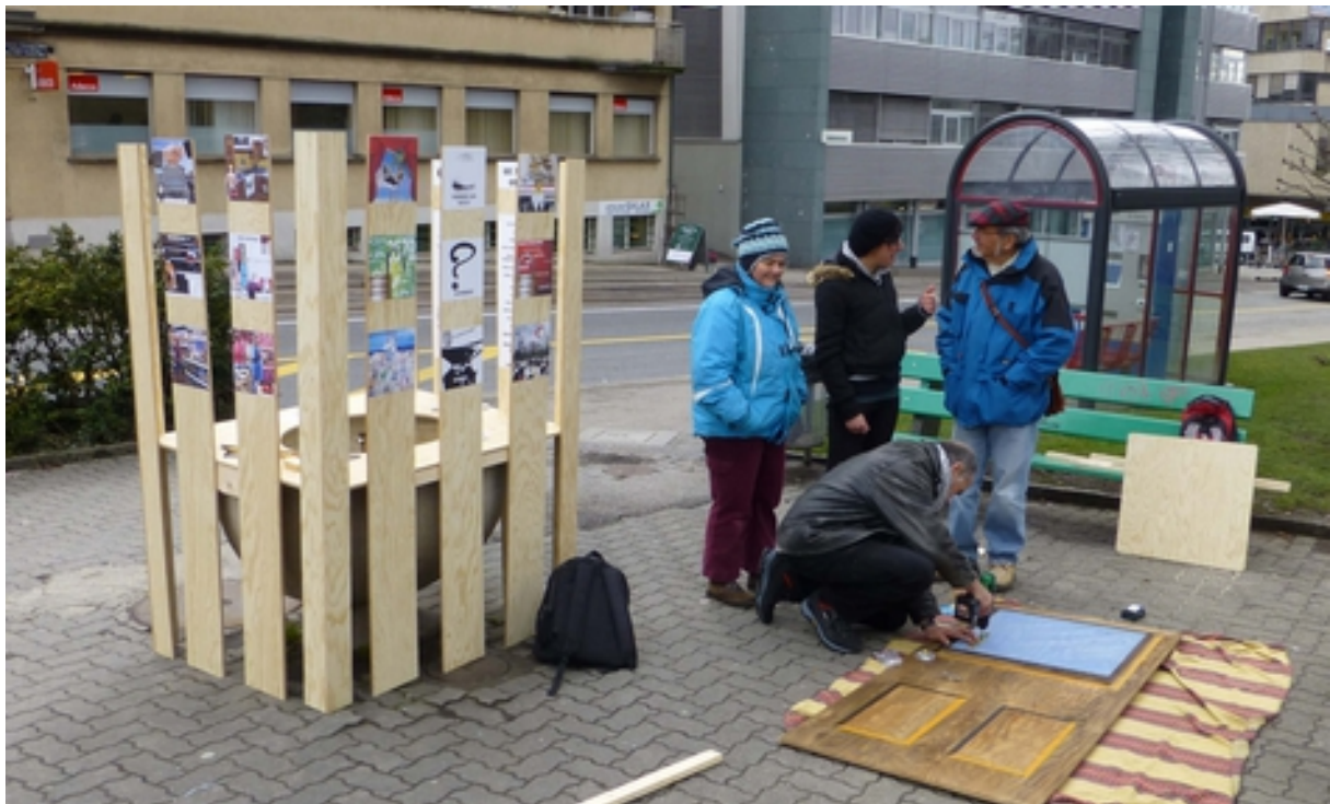
Construction de la fontaine de la gare à Nyon sur le thème d'ECODOM
